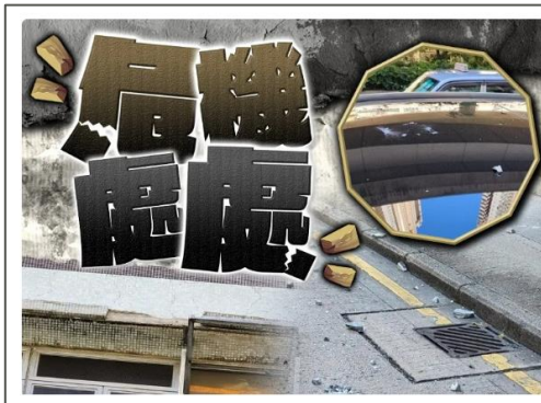
店舖橫樑塌石屎 穿假天花無人傷
